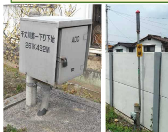
写真左：踏切制御子 写真右：特殊信号発光機
