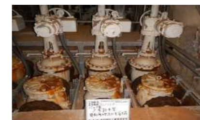
青函トンネル排水設備
