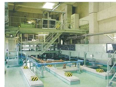
汚泥脱水施設
