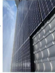
住宅用太陽光発電設備
