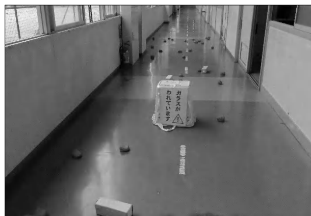
【散乱した窓ガラスの破片】
