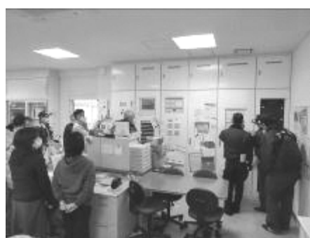
【複合火災受信機の説明を受ける様子】
