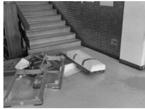
【階段下に障害物】
