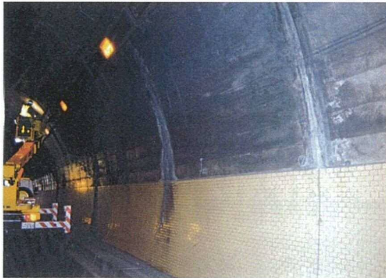
写真-解 7.4 覆工スパンの中間付近に発生したひび割れの例
