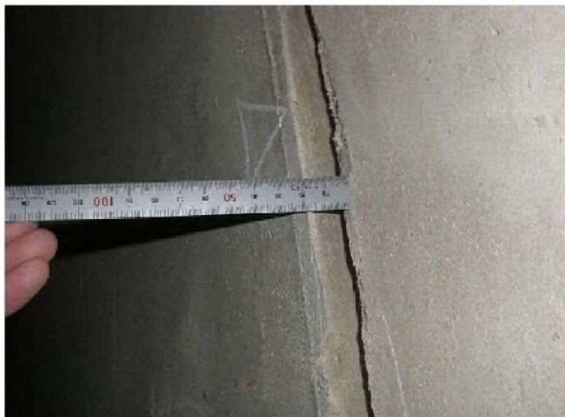
写真-解 7.8 段差の例
