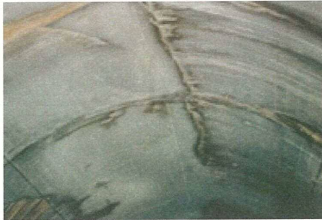
写真-解 7.3 覆工の天端付近に発生した縦断方向のひび割れの例
