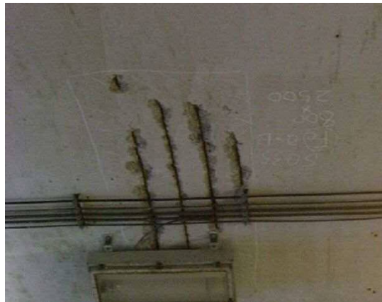
写真-解 8.2 鋼材腐食の例
