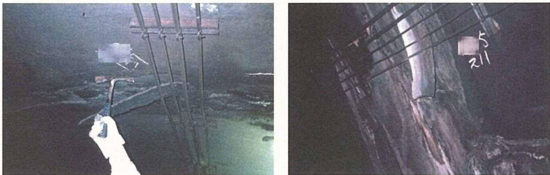
写真-解 7.9 補修モルタルが劣化してはく離している例
