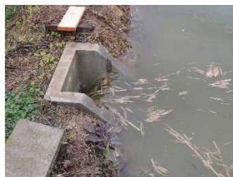
三角タイプの排水状況
