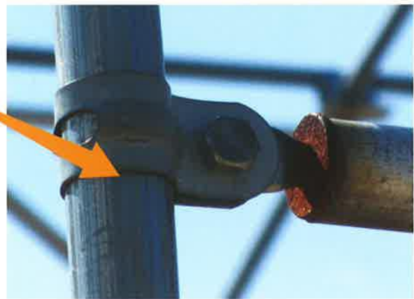
筋かい補強の妻側パイプとの接合部 (この部分が劣化しやすい)
