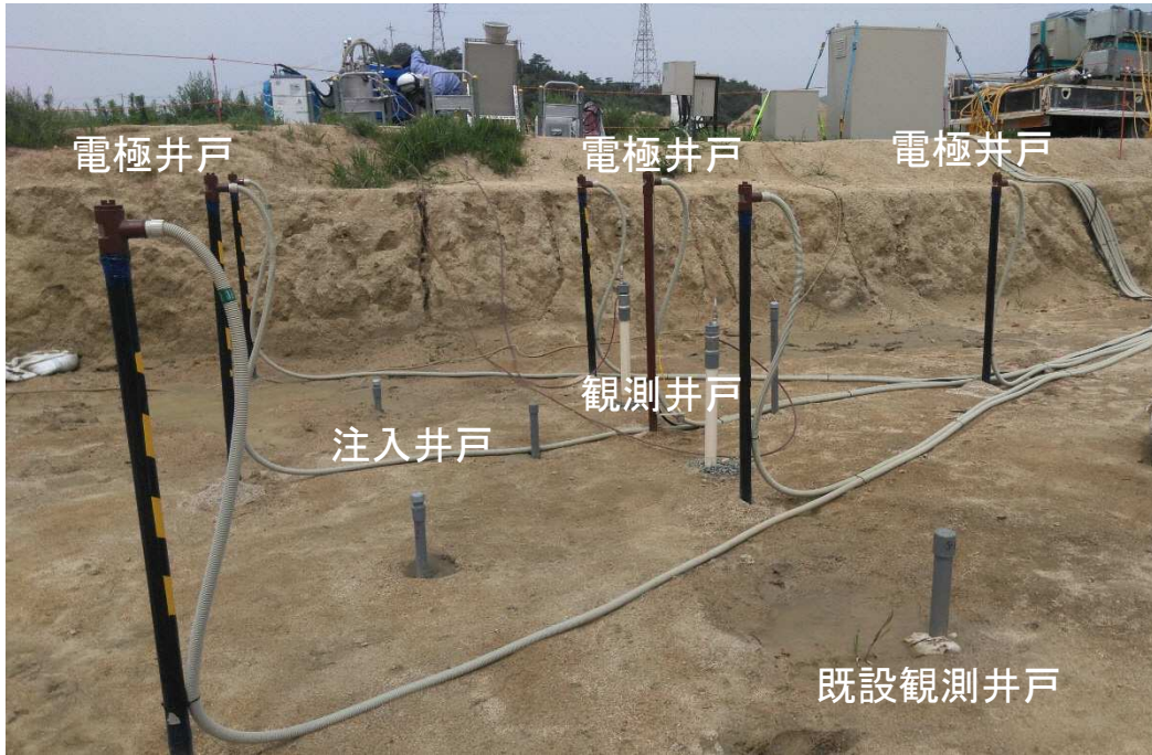
写真4 ⑨-4における通電状況
