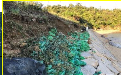
北海岸: 土堤が約40m崩壊 →10月19日までに復旧済み
