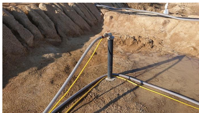
写真2 小区画㊸-7の揚水井の状況
