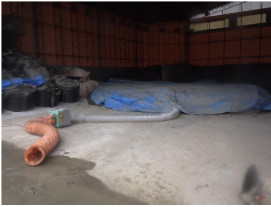
写真9 ガス吸引処理の状況
