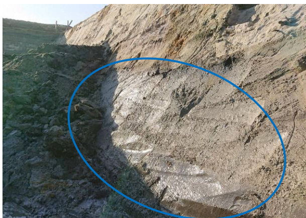
写真3 区画⑨北西側面の滲み出し水の状況
