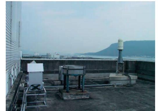
センター屋上に設置されたサンプリング装置
