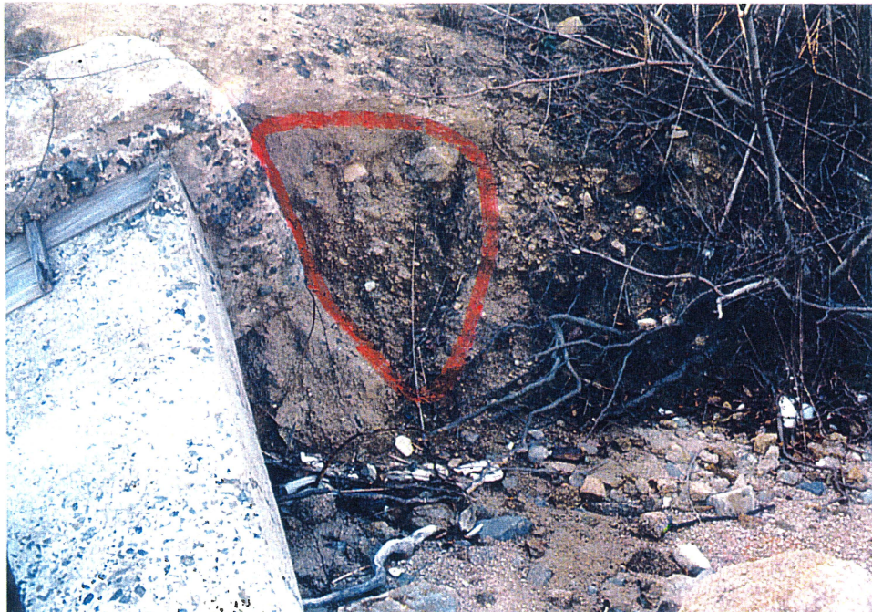
D測線の西側 の変状状況
