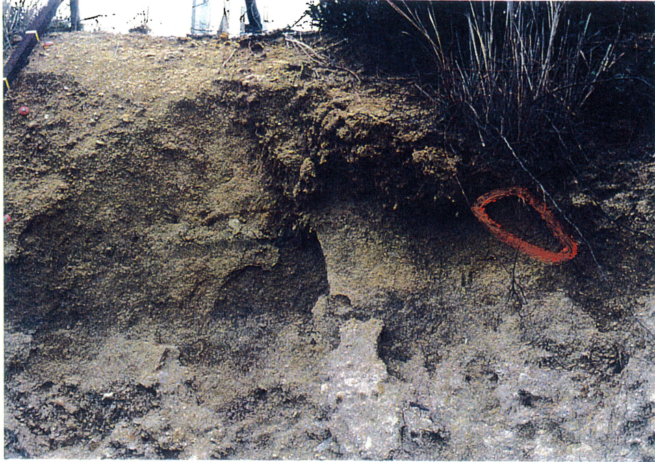
EF測線の西側 の変状状況
