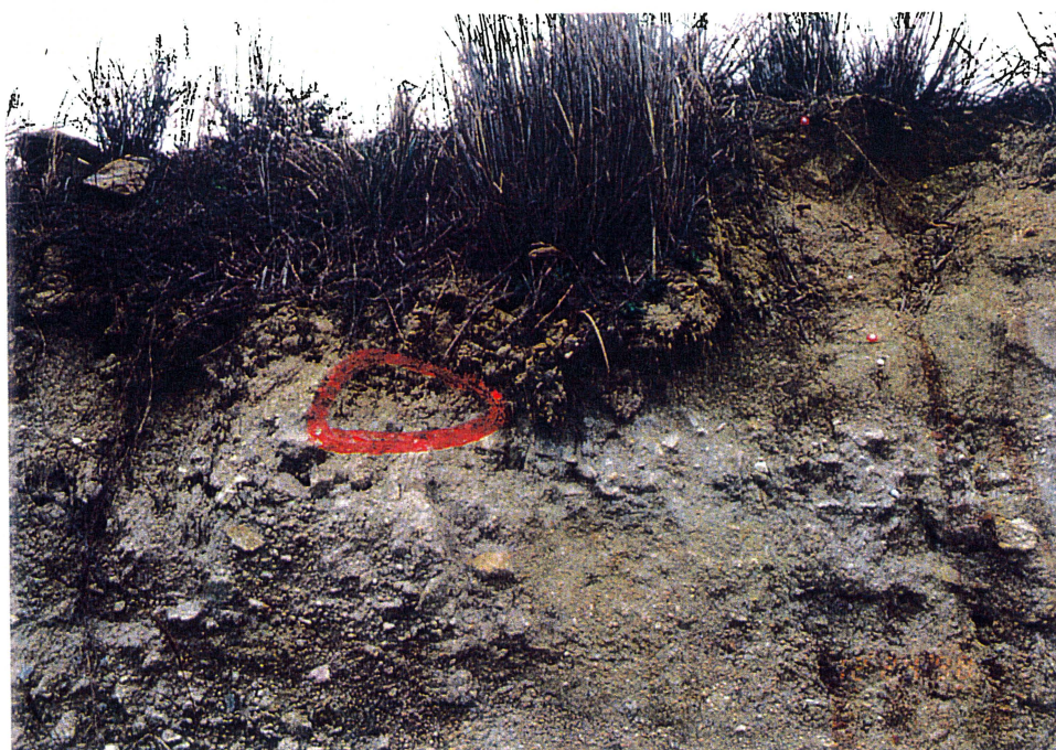
E+8m測線の東側 の変状状況
