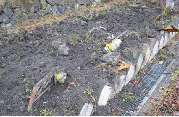
掘り起し被害
