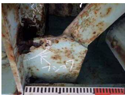
【主桁端部の腐食】
