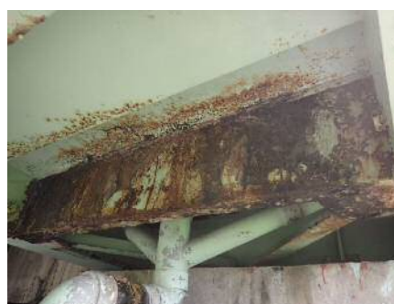
【横桁（階段部）の腐食】
