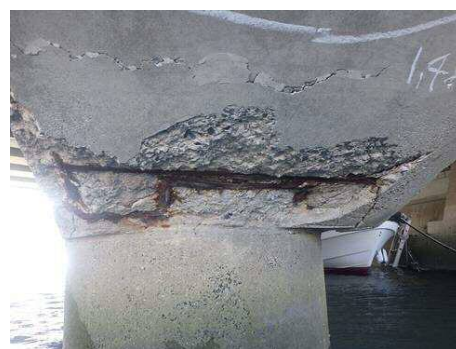
【コンクリート（床版）橋の剥離・鉄筋露出】
