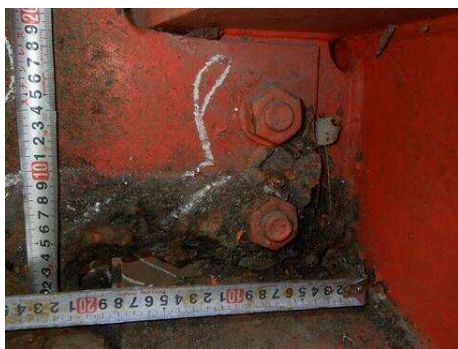
【鋼橋（主桁端部の腐食）】
