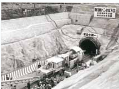
新鋭機のトンネルマシン（香川側） 出典：香川用水土地改良区30年史
