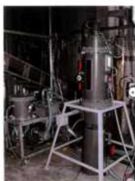
接続装置と一次脱臭施設
