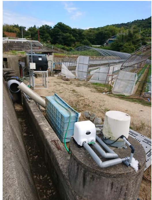
井戸水からの給水
