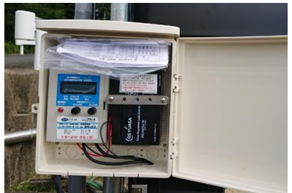
制御装置で1回当たりの給水時間を制御
