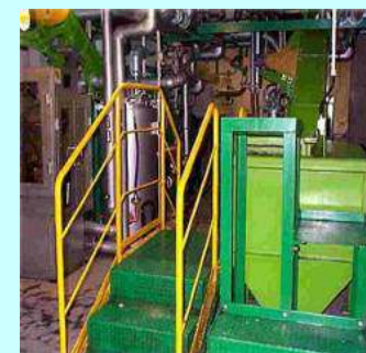
食品廃棄物などの飼料化設備
