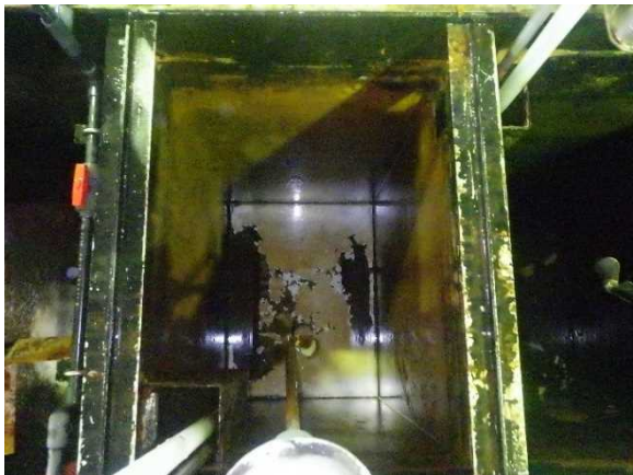
洗淨後 写真9 第1混和槽
