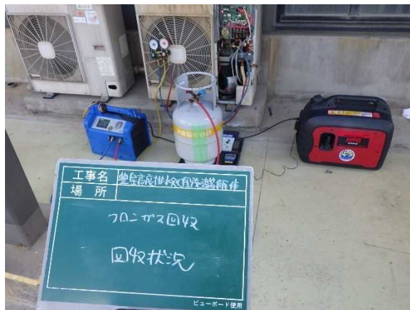
フロン回収状況
