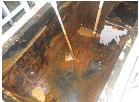
洗淨後 写真 12 第 1 中和槽
