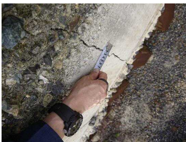
写真2 ひび割れ幅の状況
