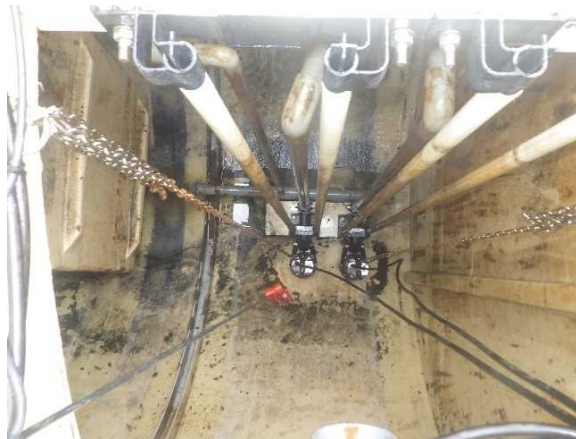
洗浄後 写真 24 凝集膜分離装置
