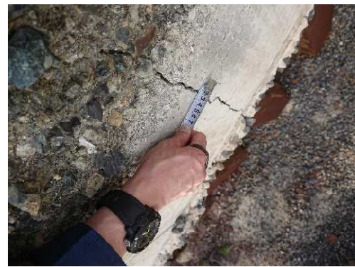
写真6 笠コンのひび割れ状況（近景） （FG 測線の間近付）
