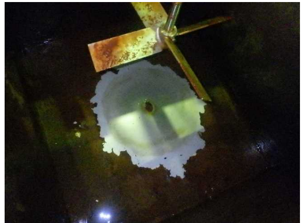
洗淨後 写真10 凝集槽
