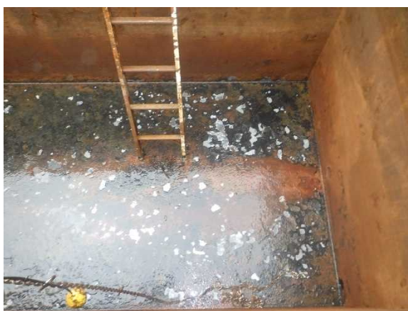
洗浄後 写真 23 原水槽
