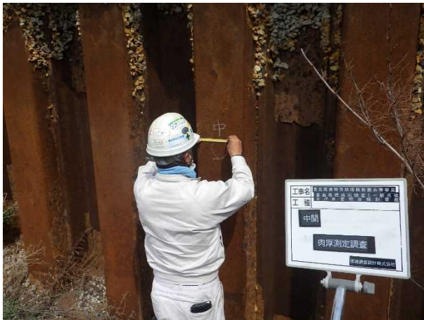
写真 3 肉厚測定箇所-研磨前 (中間)
