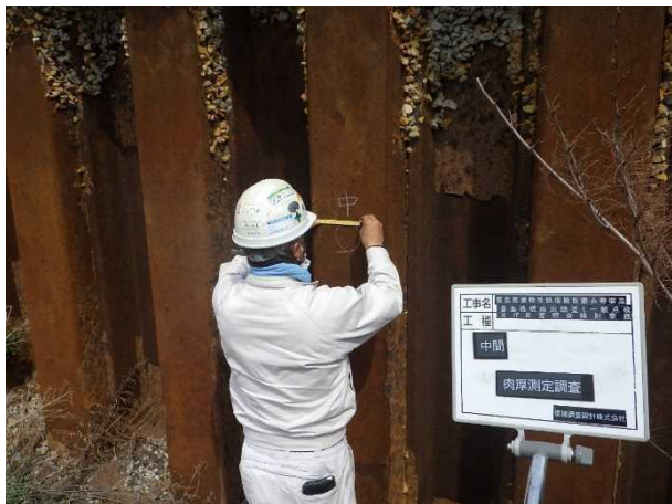
写真 3 肉厚測定箇所-研磨前 (中間)
