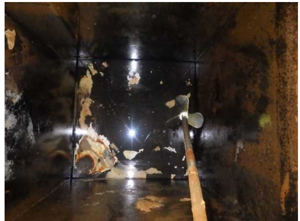
洗淨後 写真8 反応槽
