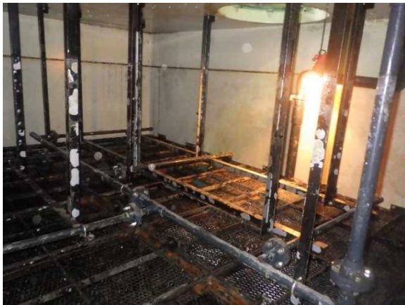
洗浄後 写真 15 脱窒槽
