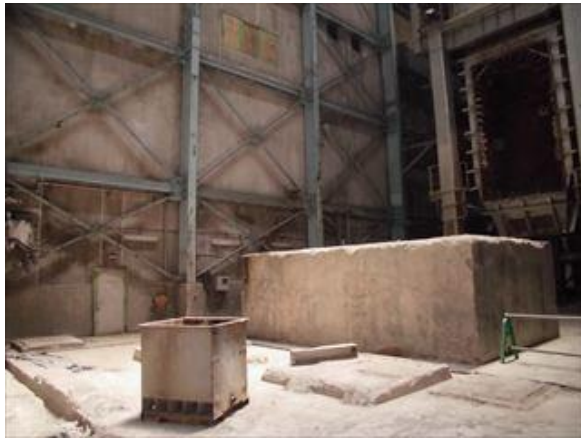
溶融炉基礎及び煙道解体前 (南棟内中央部から南東方向を撮影)
