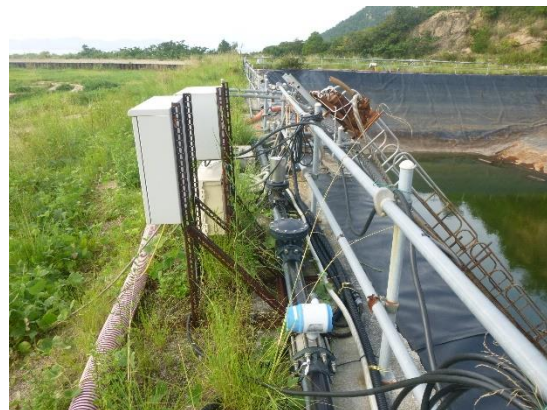
写真2 送水管（貯留トレンチ～活性炭吸着塔）
