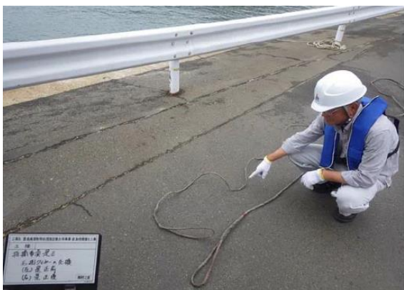
写真15 鋼管吊り上げ用のワイヤーの交換 (左側 是正前、右側 是正後)
