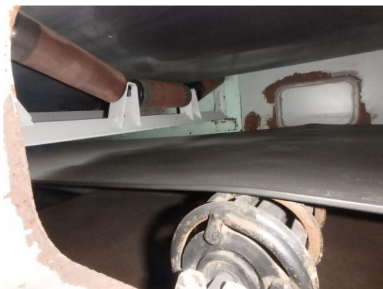
①第 2 可燃物搬送コンベヤ (内部)
