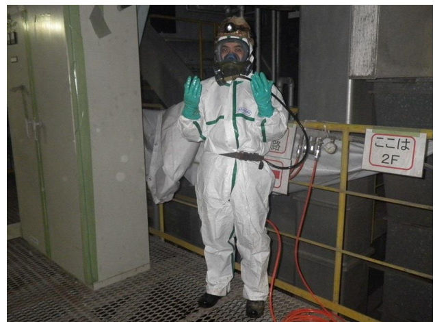
④保護具の着用状況 (写真はレベル 3 の保護具)
