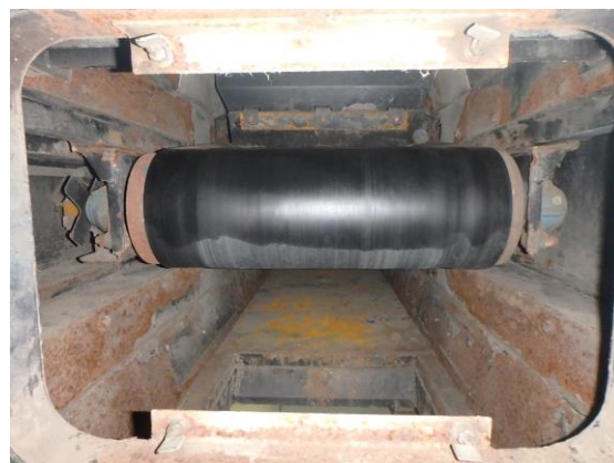
②第 1 不燃物搬送コンベヤ (内部)
