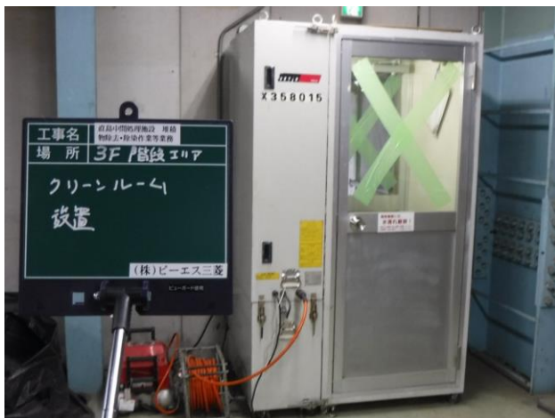
③クリーンルームの設置状況
