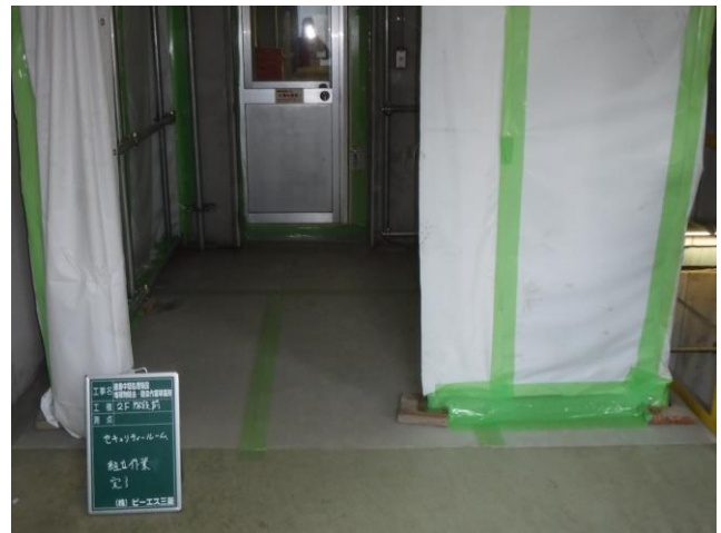
②セキュリティールームの設置状況
