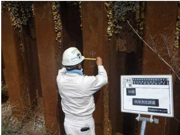
写真 3 肉厚測定箇所-研磨前 (中間)
