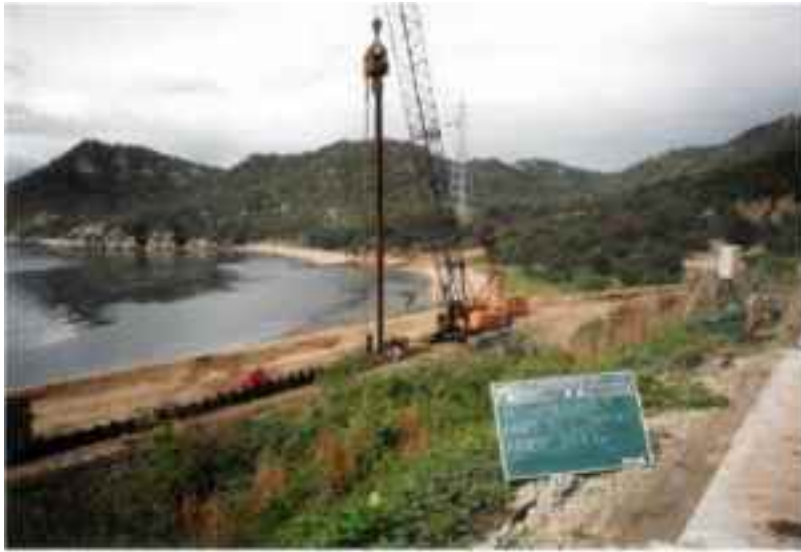
バイブロハンマによる打設状況【H12暫定的な環境保全措置工事（第1工区）】
