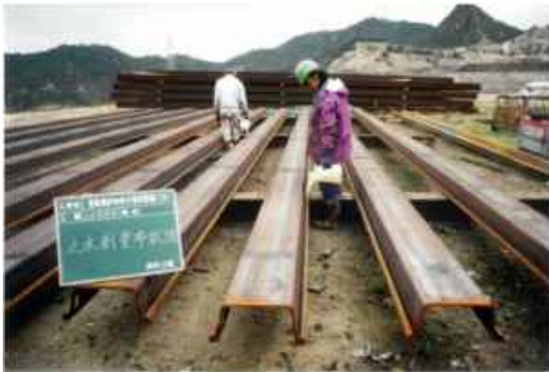
鋼矢板への止水材塗布状況【H12暫定的な環境保全措置工事（第1工区）】
