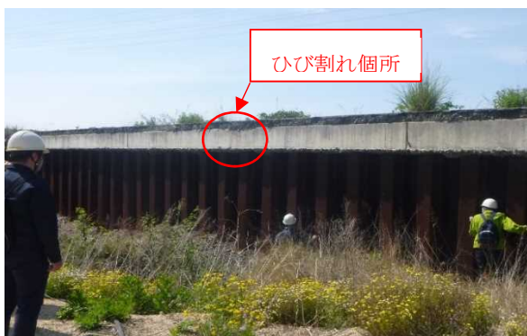
写真13 笠コンのひび割れ状況（全景） （FG 測線の間中間付近）
