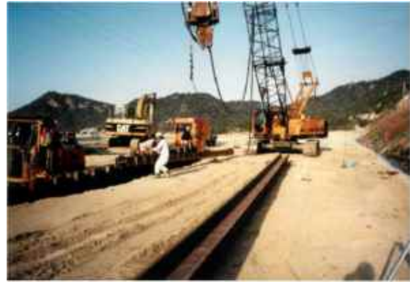
バイブロハンマによる打設状況【H12暫定的な環境保全措置工事（第1工区）】
