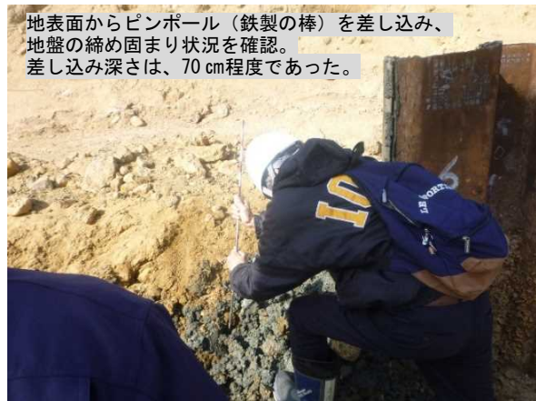
写真 36 松島委員立会状況（引抜き跡）
