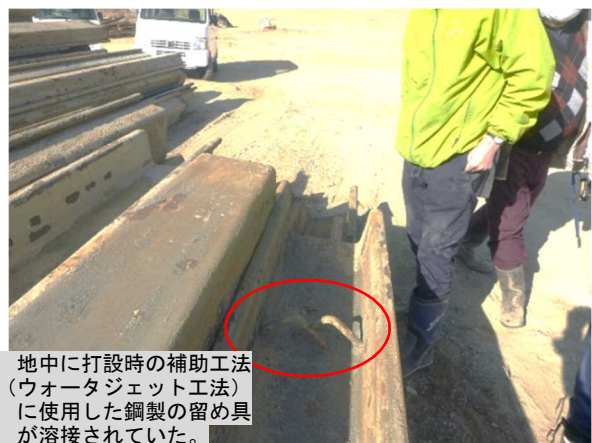
写真 32 鋼矢板側面に溶接された鋼製の留め具
