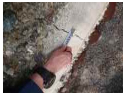
写真6 笠コンのひび割れ状況（近景） （FG 測線の間付近）
