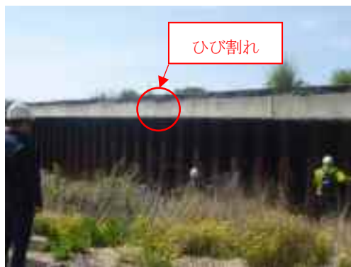
写真5 笠コンのひび割れ状況（全景） （FG 測線の間付近）
