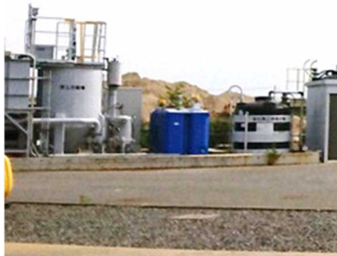
写真1 加圧浮上装置
