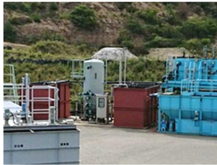
写真3 活性炭吸着塔
