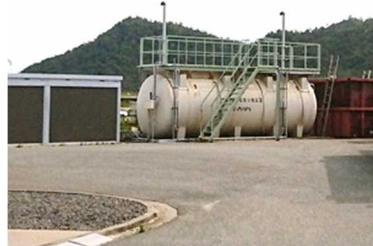
写真2 凝集膜分離装置
