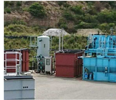
写真3 活性炭吸着塔
