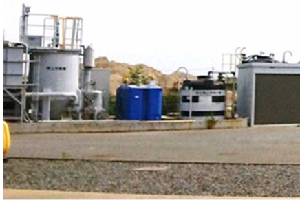
写真1 加圧浮上装置
