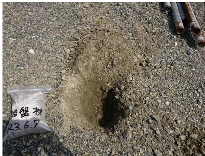
写真1 アスファルト舗装下の路盤材（中間保管・梱包施設跡地周辺） 令和3年6月
