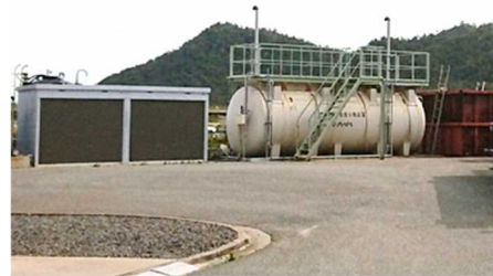
写真2 凝集膜分離装置
