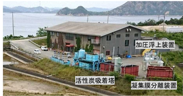
写真4 簡易地下水処理施設（全景）
