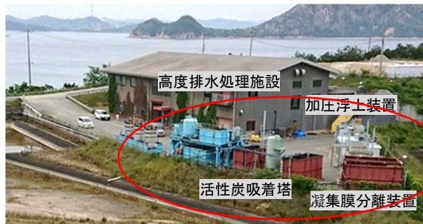
赤枠内の3施設は簡易で、高度排水処理施設には含まれない。
