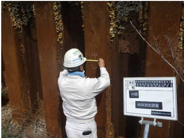
写真 3 肉厚測定箇所-研磨前 (中間)
