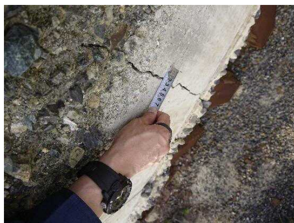
写真2 ひび割れ幅の状況
