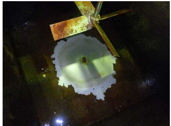
洗淨後 写真10 凝集槽
