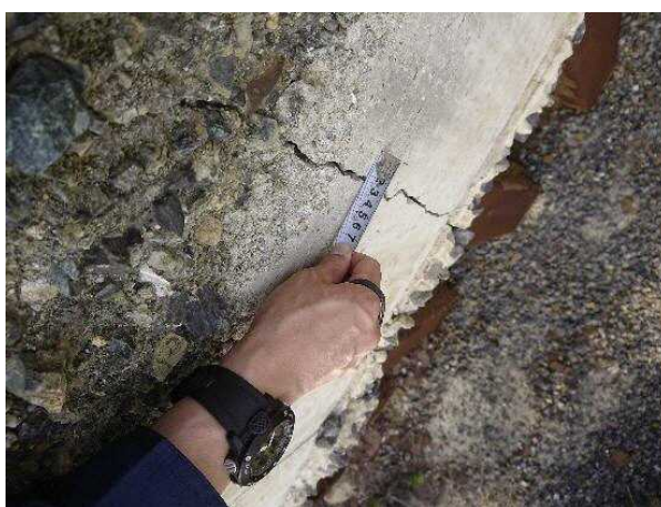
写真2 ひび割れ幅の状況
