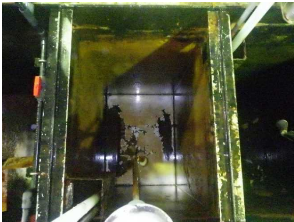
洗淨後 写真9 第1混和槽
