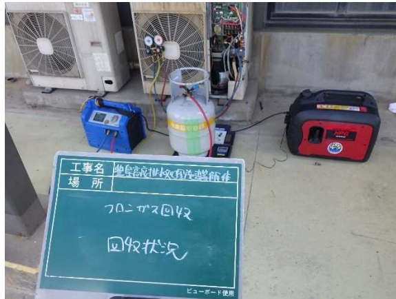
フロン回収状況
