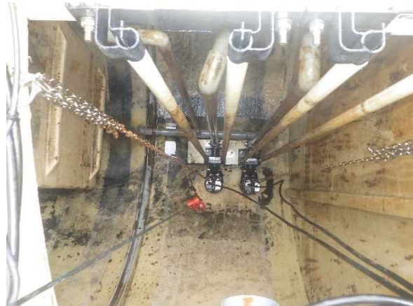
洗浄後 写真 24 凝集膜分離装置
