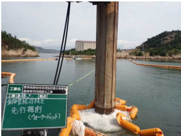
鋼管杭外周掘削状況 (ケーシング及びウォータージェット、近景)
