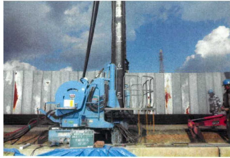
クラッシュパイラーによる圧入状況【H27北海道トレンチドレーン撤去及び仮設矢板設置工事（第1工区）】
