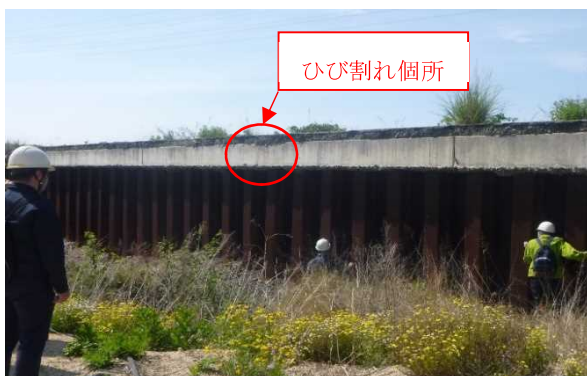
写真13 笠コンのひび割れ状況（全景） （FG 測線の間近付）
