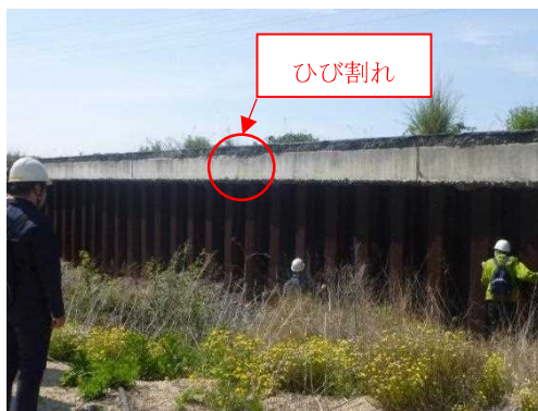
写真5 笠コンのひび割れ状況（全景） （FG 測線の間近付）
