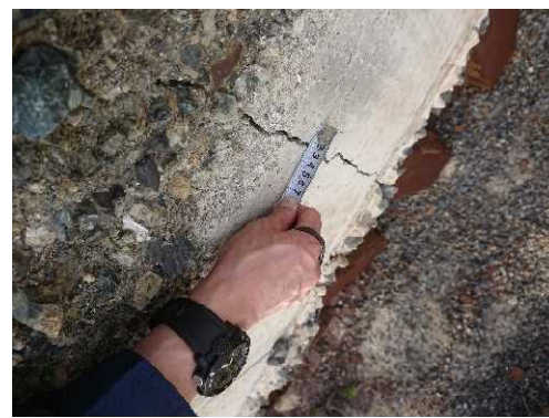
写真6 笠コンのひび割れ状況（近景） （FG 測線の間近付）
