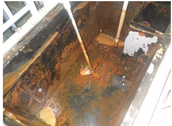
洗淨後 写真 12 第 1 中和槽
