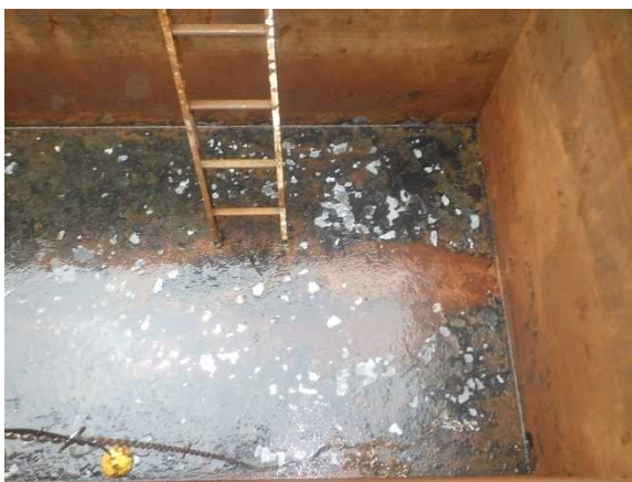
洗浄後 写真 23 原水槽
