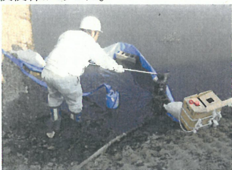
写真1 沈砂池1攪拌・採水
