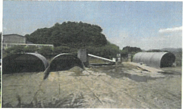
2. 受入れヤード内土壌保管用ドーム
