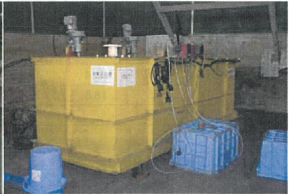
4. 反応槽、攪拌機
