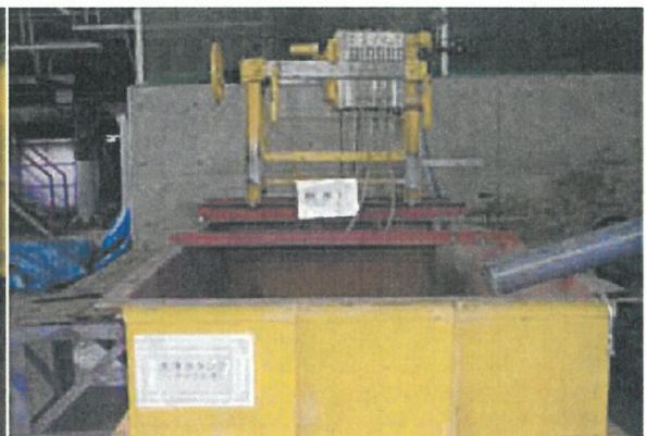
6. 脱水機、洗浄水タンク
