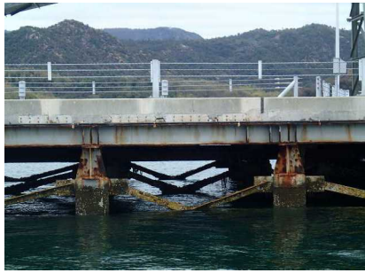
① 表面仕上げモルタルの剥離
