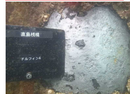
⑧ 杭No.4-1(付着物を除去した鋼材表面)
