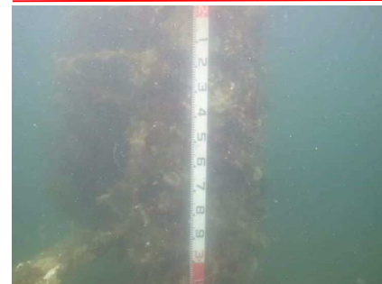
⑦ 鋼材の表面状態 (杭頭金物・下端2m~3m)
