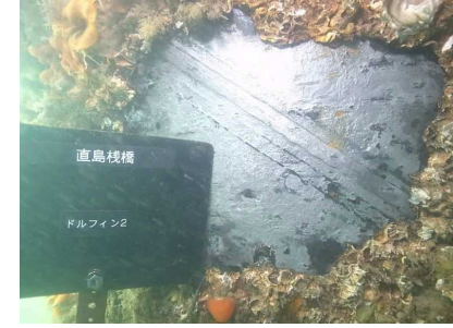
⑥ 杭No.2-1(付着物を除去した鋼材表面)
