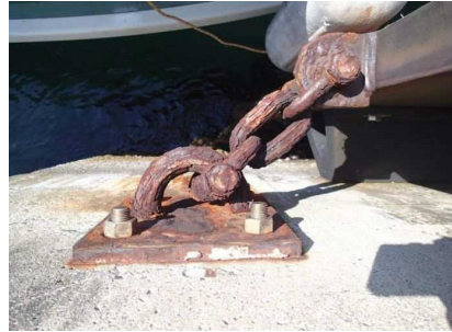
② 防舷材取付け用金具（リング及びシャックル）の腐食
