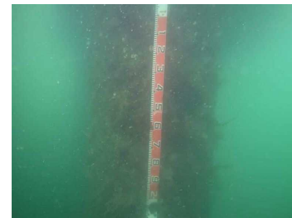
⑥ 鋼材の表面状態 (杭頭コンクリート・下端-1m～2m)
