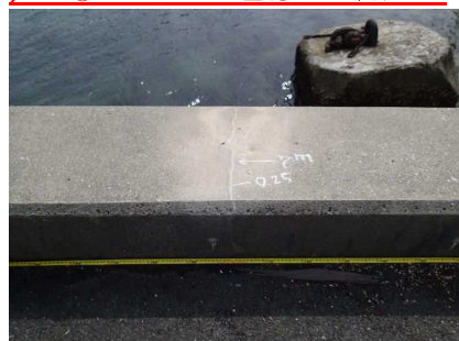
③ ガードロープ基礎にひび割れ
