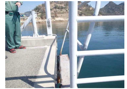
⑥ 防護柵の傾き
