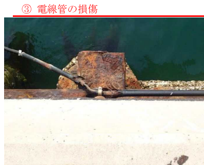
③ 電線管の損傷
