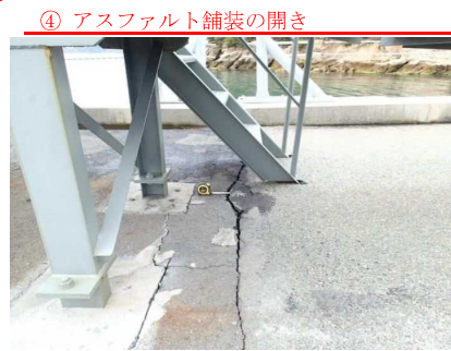
④ アスファルト舗装の開き
