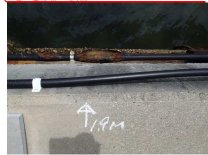
④ 電線管の損傷
