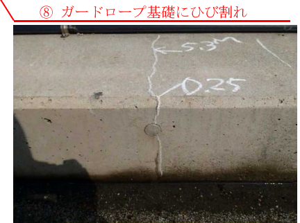
⑧ ガードロープ基礎にひび割れ
