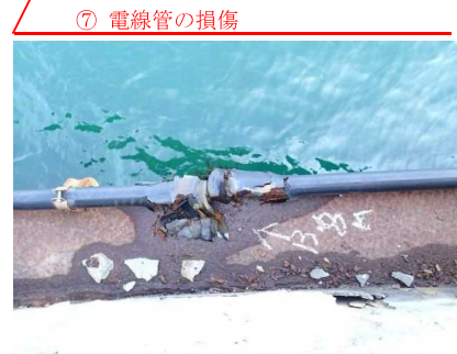
⑦ 電線管の損傷
