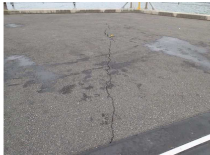
① アスファルト舗装のひび割れ
