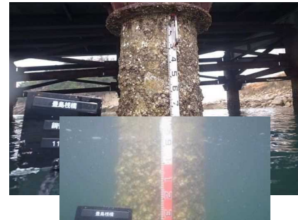
⑤ 鋼材の表面状態 (杭頭金物・下端~1.3m)
