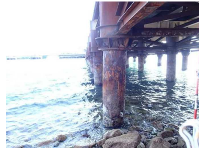
⑤ 鋼管杭の外観（変位）状況
