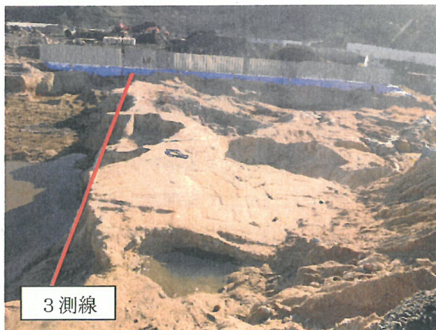
写真1 3測線南側の状況 (3～3+20)
