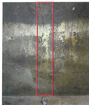
コンクリートのひび割れに沿った塗装の浮き(第5槽)
