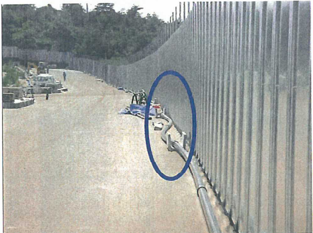
熱による配管の歪み
