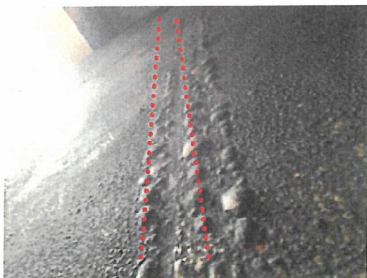
亀裂に沿った膨れの伸長(1)
