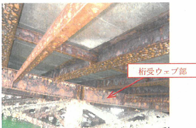
写真6 連絡橋部の桁受け腐食状況
