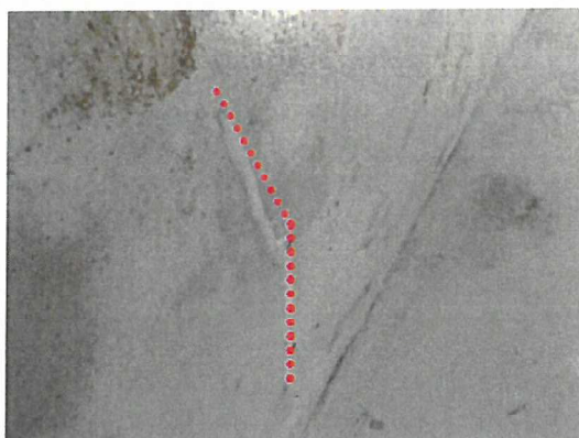
亀裂に沿った膨れの伸長
