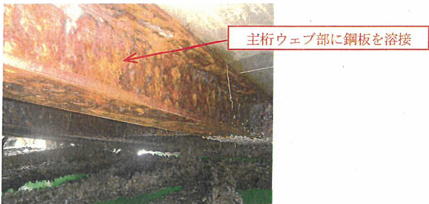
写真2 車両乗降部主桁の腐食状況
