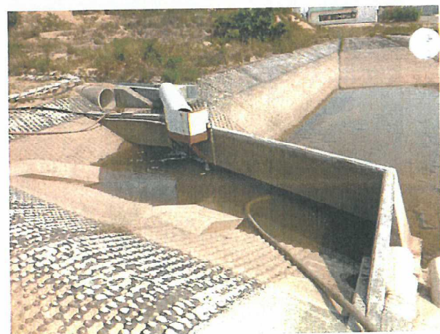
初期雨水貯留槽 ・沈砂池 2 への越流は無し
