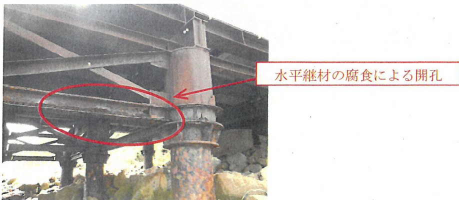
写真3 水平継手材の腐食による開孔状況
