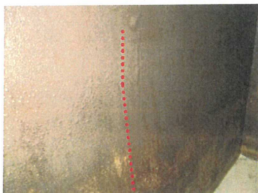
亀裂に沿った膨れの伸長
