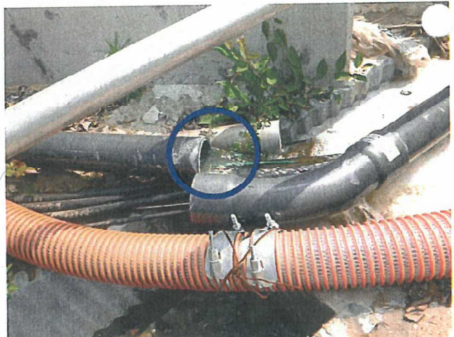
HIVP 管の外れた箇所 (管の白色の部分は接着剤)
