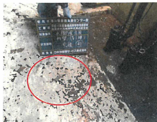
床面防食面の剥離
