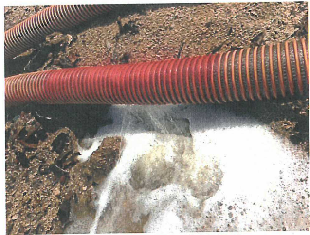
H25.7.25 送水試験時の漏水箇所
