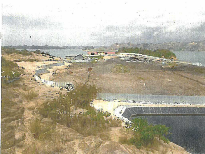
写真1：大雨前の状況（8/23撮影）
