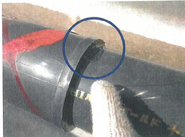
しみ出し箇所
