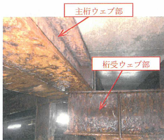
写真5 車両乗降部の主桁及び桁受け腐食状況
