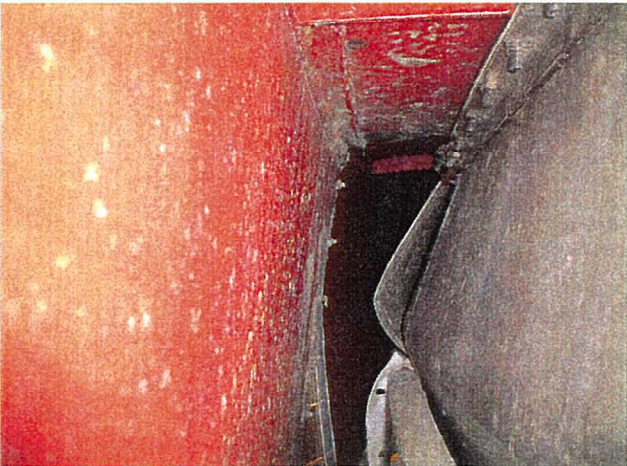
シール板の膨み
