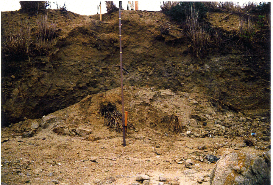
3月27日の変状状況 (西側の部分が崩落)
