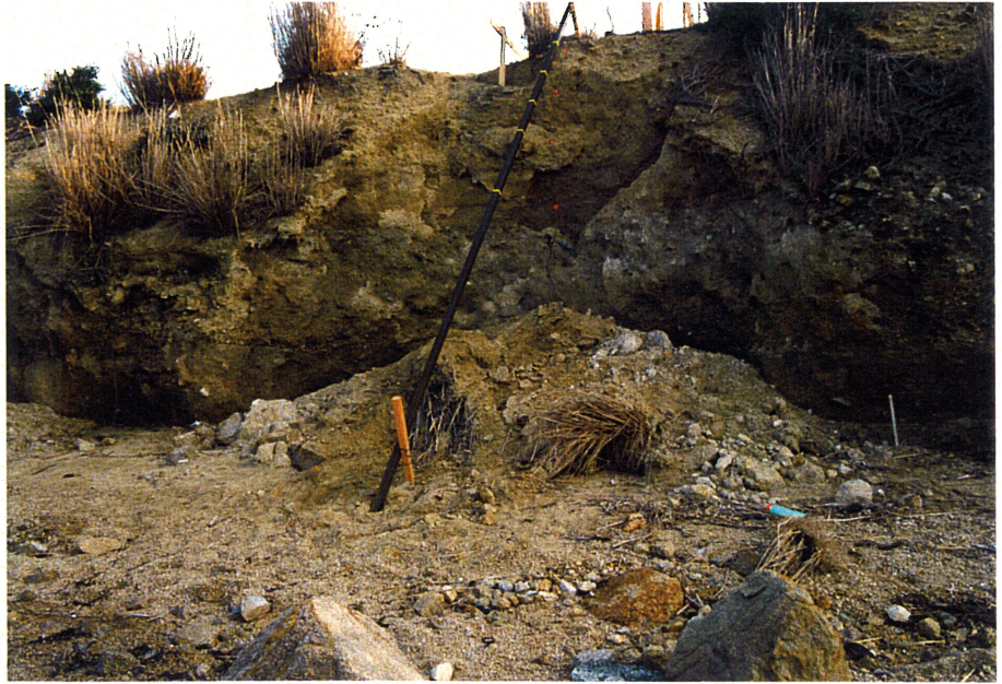
2月13日の変状状況
