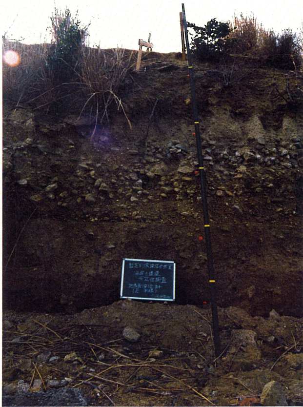
2月13日(設置時)の変状状況
