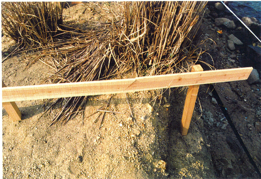
簡易伸縮計設置状況
