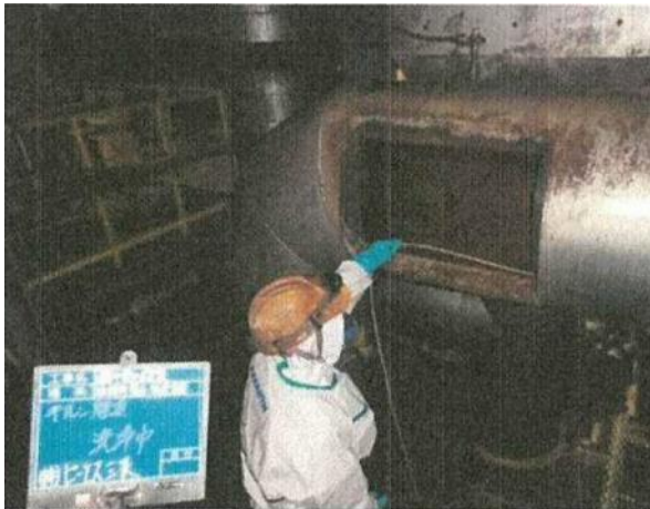
高圧洗浄による除去・除染作業中 (煙道切取り部分を撮影)
