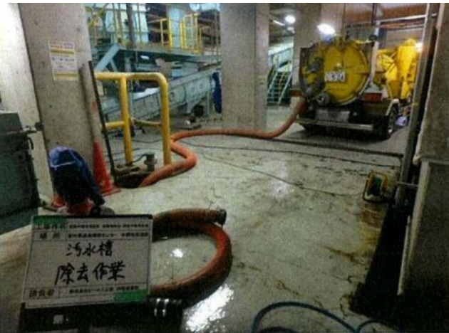
バキューム車による除去・除染作業中 (汚水貯留槽付近を撮影)
