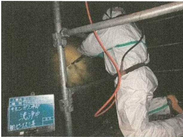
高圧洗浄による除去・除染作業中 (キルンガス冷却室内部を撮影)
