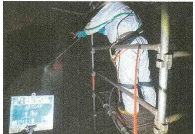
高圧洗浄による除去・除染作業中 (ガス冷却設備内部を撮影)
