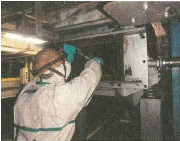
高圧洗浄による除去・除染作業中 (キルン残さライン点検口付近を撮影)
