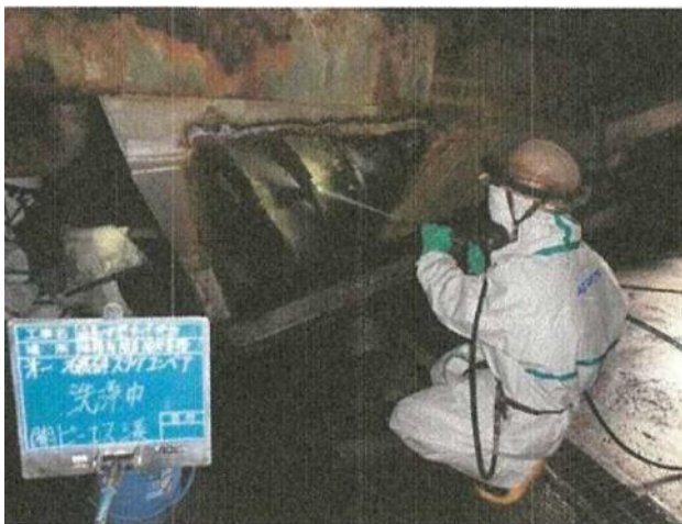
高圧洗浄による除去・除染作業中 (第1 破碎スラグコンベヤを撮影)
