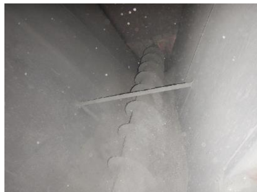
ダストコンベヤ 作業前
