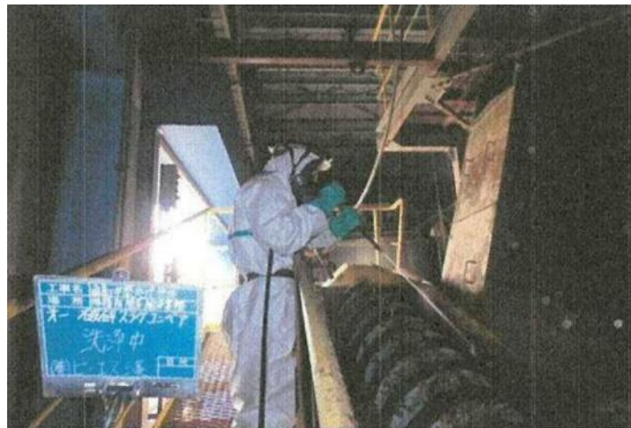
高圧洗浄による除去・除染作業中 (第1 破碎スラグコンベヤを撮影)
